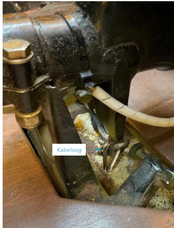
Kabeloog zonder kabel
